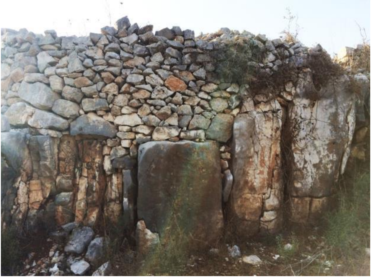
صورة رقم (25): سنسلة مبنية دون أساس، فوق صخور موجودة أصلاً في الموقع. تصوير الباحثة، 4 تشرين الثاني 2021.
